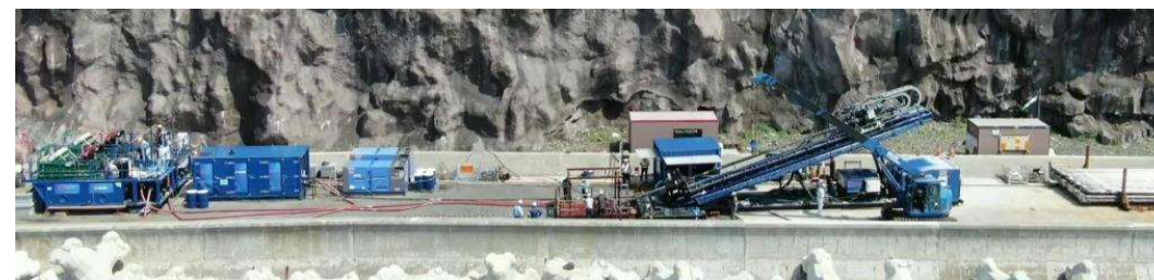
配置状況（主要機器のみ・水槽等は遠隔設置）
